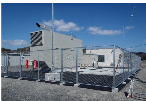
非常用発電機(手前)及び新電気室(奥)
