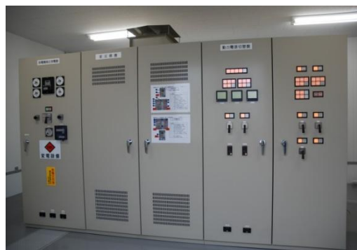
新電気室(内部)
